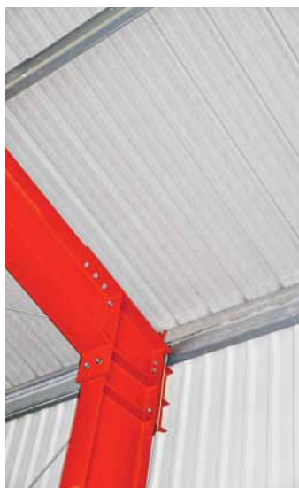
Antitropfbeschichtung: Damit keine Feuchtigkeit vom Dach in die Halle tropft, gehört die Beschichtung heute beim Hallenbau zum Standard.
