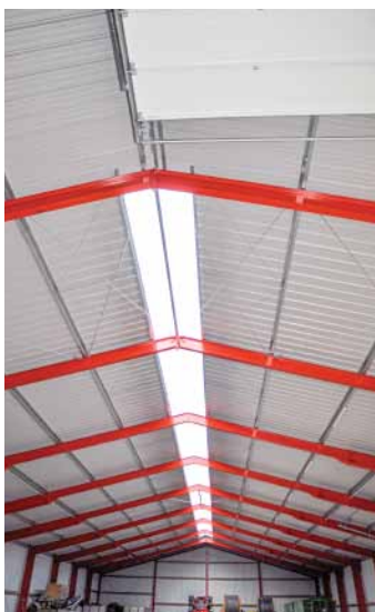
Lichtfirst: Von oben strahlt das Licht in die Halle. Es ist angenehm hell, die Lichtausbeute ist viel höher als mit seitlichen Lichtbändern.
